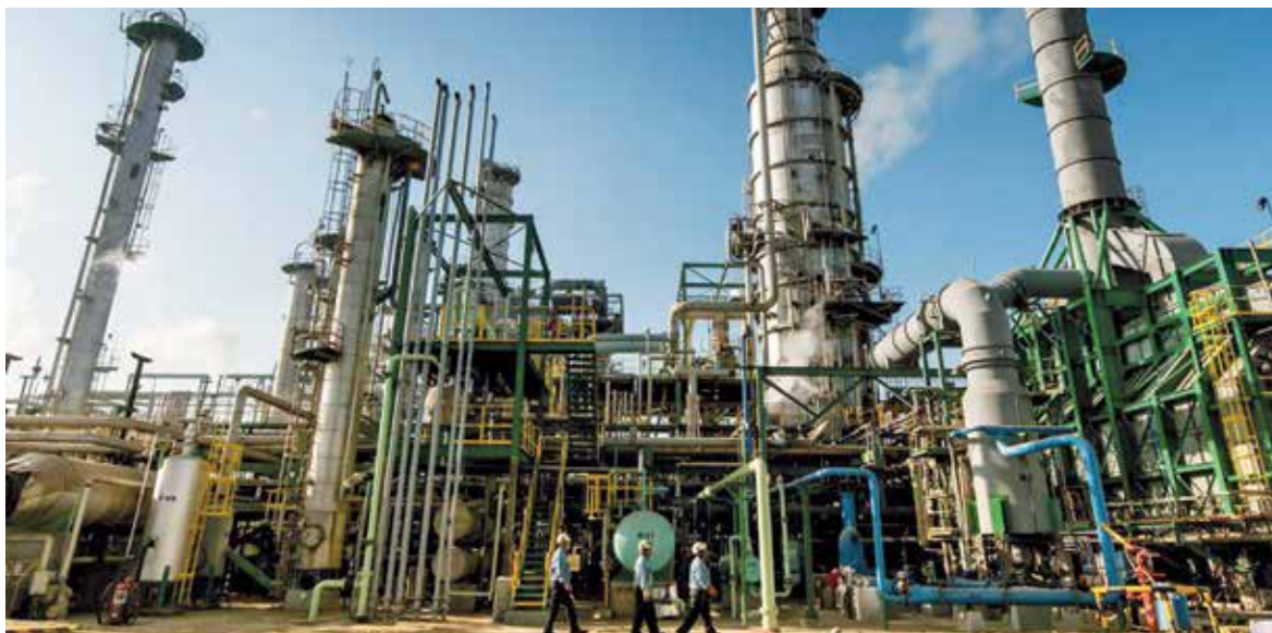
En septiembre del 2018, Repsol inauguró la instalación de combustibles líquidos de bajo azufre en Refinería de La Pampilla.
