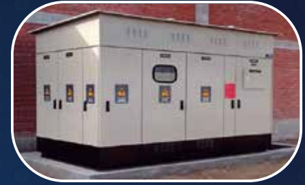
SUBESTACIÓN ELÉCTRICA COMPACTA
